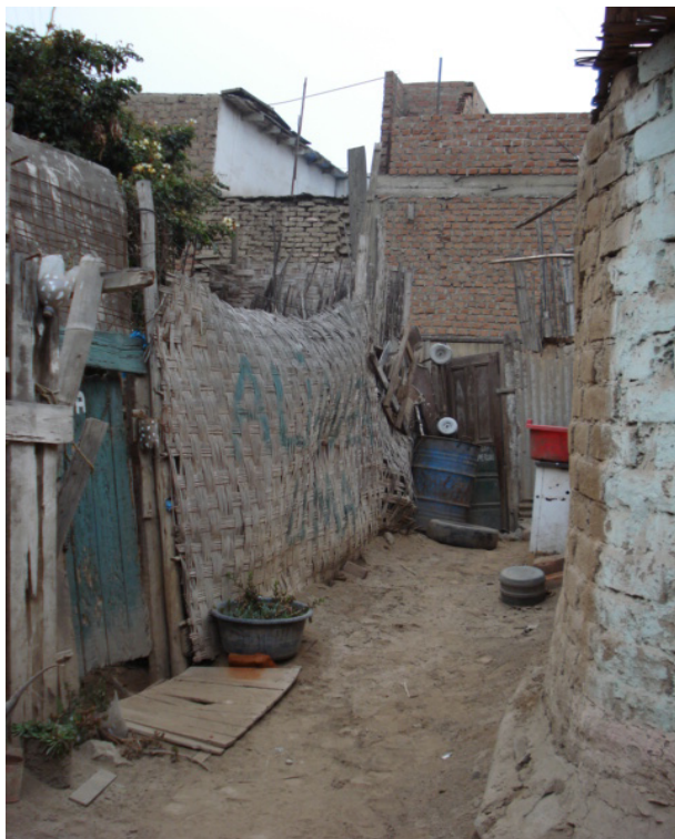
Figura 2. Las viviendas sin mantenimiento
