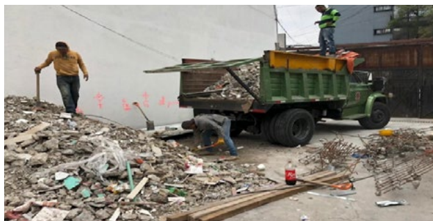
Figura 11. Residuos a tiro libre, producto de diferentes etapas constructivas
